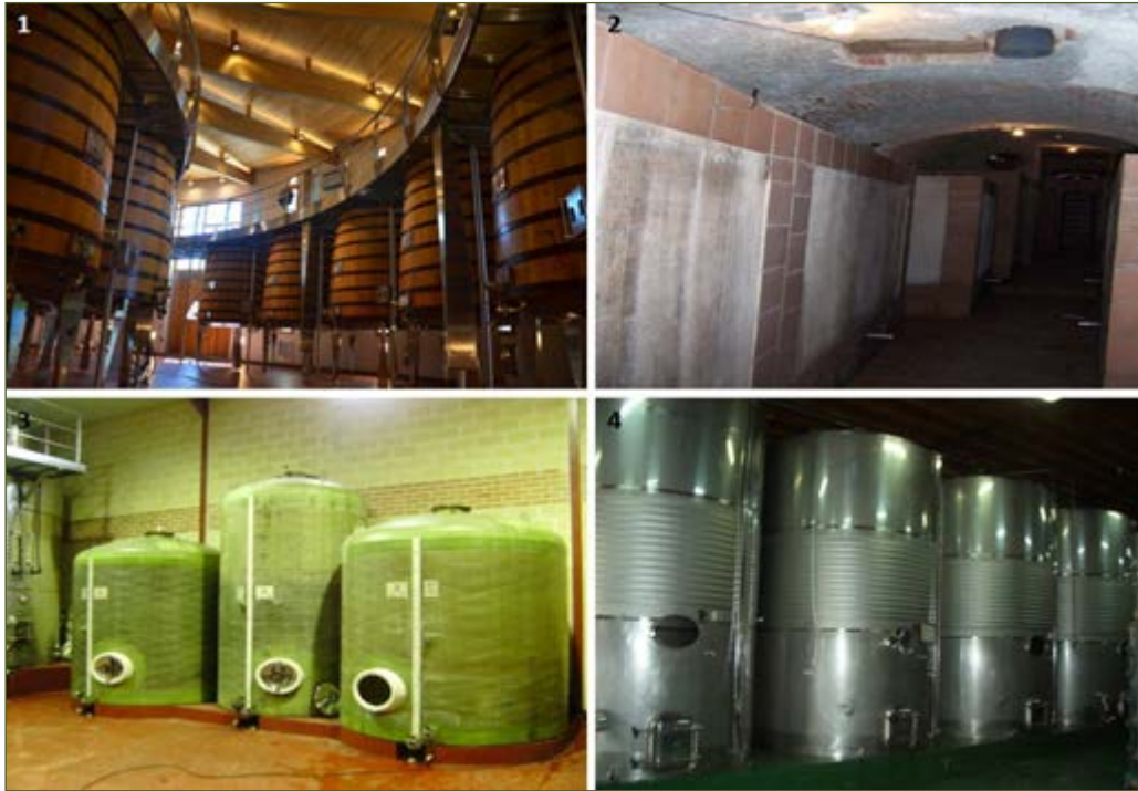
1) Tinos de madera de la Bodega Vegasicilia en la D.O.P. Ribera del Duero (Mayo de 2014); 2) Tino de cemento de la bodega Alfredo Santamaría en la D.O.P. Cigales (Abril de 2007); 3) Tinos de poliéster en la Bodega Valeriano Sánchez en la D.O.P. Cigales (Septiembre de 2009); 4) Tinos de acero inoxidable en la Bodega Prada a Tope en la D.O.P. Bierzo (Febrero de 2006).
